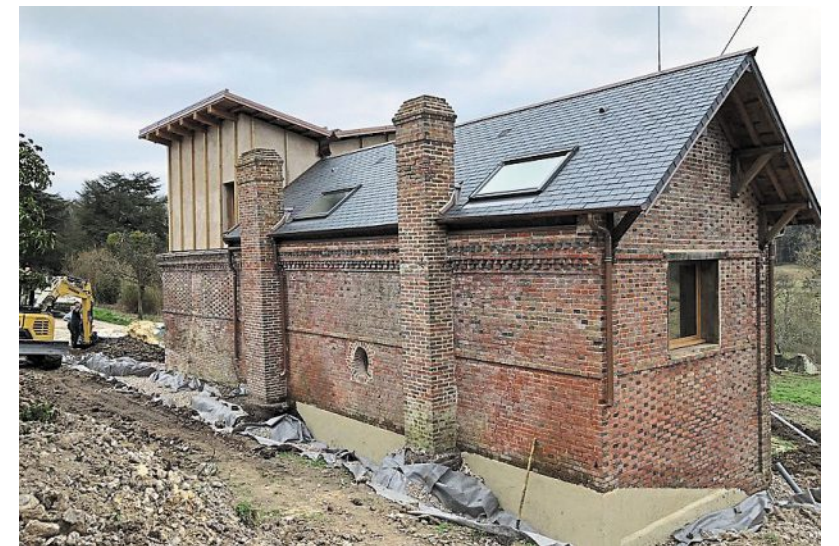
Les travaux doivent être terminés en mai, pour une inauguration début juillet.
